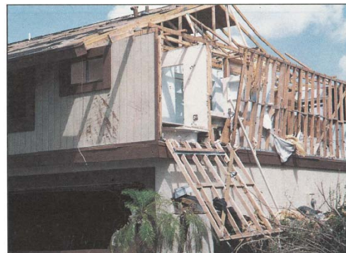
(d) Gable end and side wall failure in Andrew (FEMA 1992)
