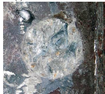
(d) Dowel shear without rebar
